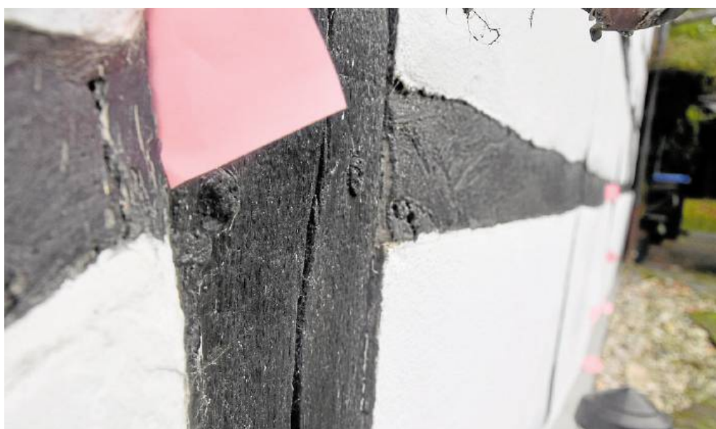
Mit den pinken Zetteln markiert Heitmann die Risse in der Wand.
