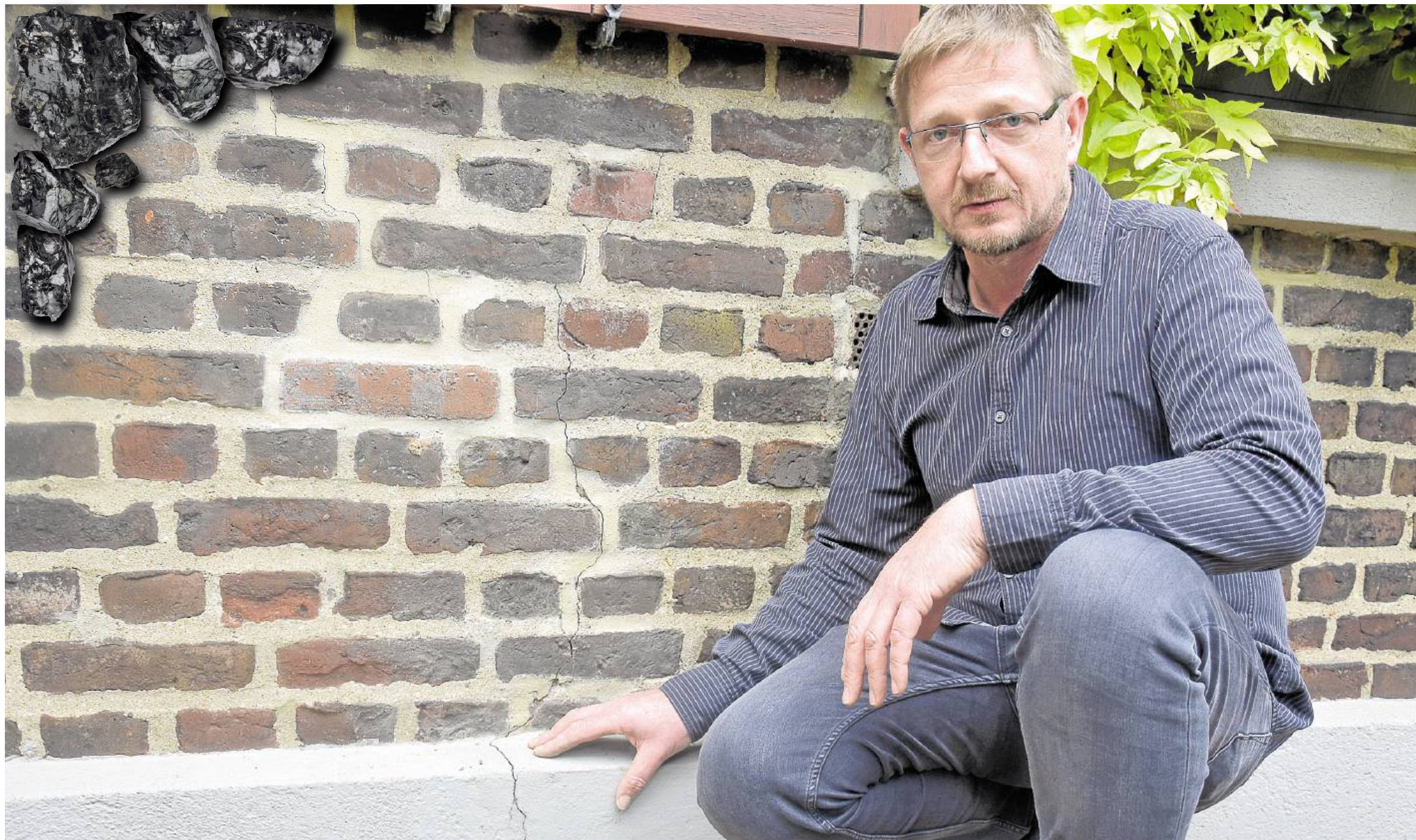
Einige Risse in Stephan Heitmanns Haus ziehen sich durch die ganze Wand und gehen bis in das Fundament.
