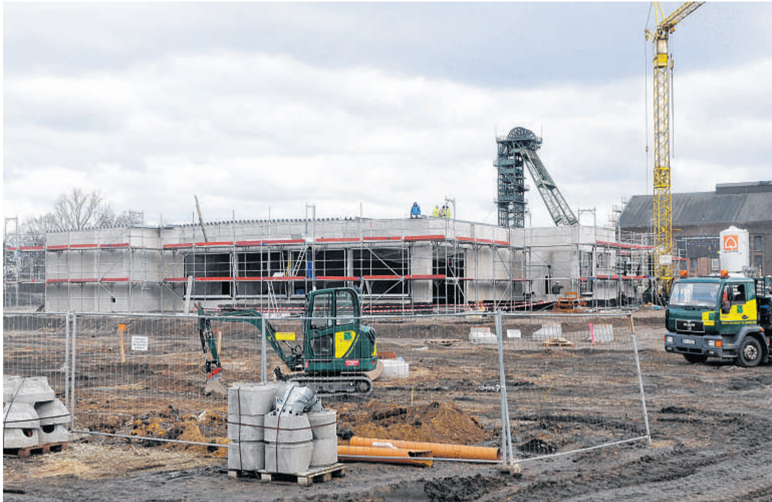
Große Fortschritte macht der Neubau des Aldi-Marktes hinter der Kae des ehemaligen Bergwerks Fürst Leopold.
