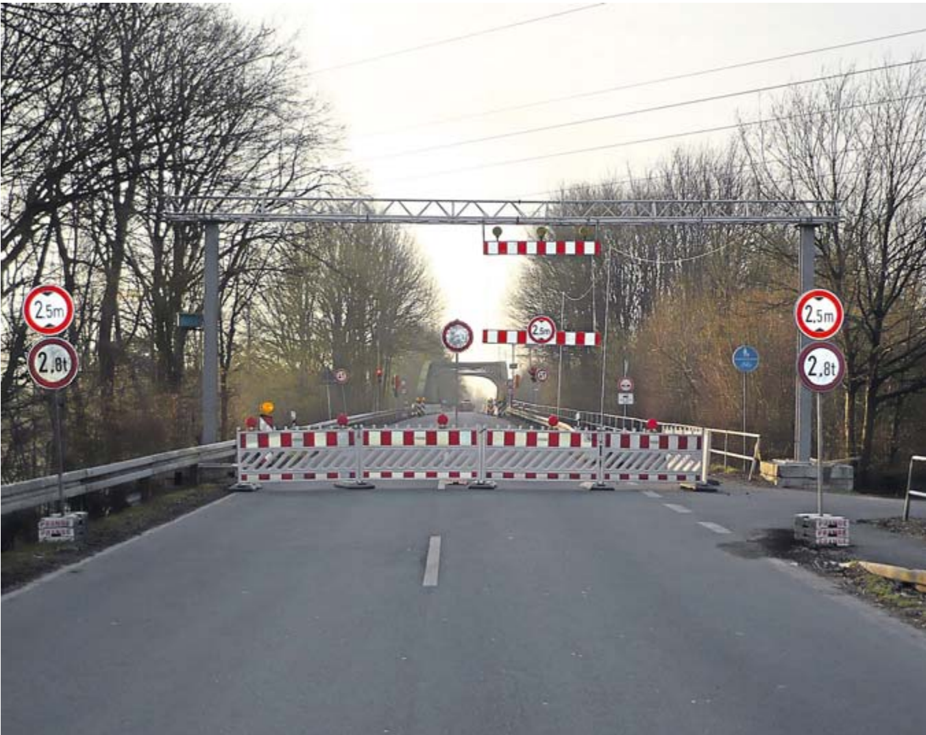
Verbotsschilder, soweit das Auge reicht: Die Hervest Brücke wird am Montag (21.) vom Wasser- und Schifffahrtsamt gesperrt. An der Brücke müssen wegen ihres fortgeschrittenen Alters Sanierungsarbeiten ausgeführt werden.
