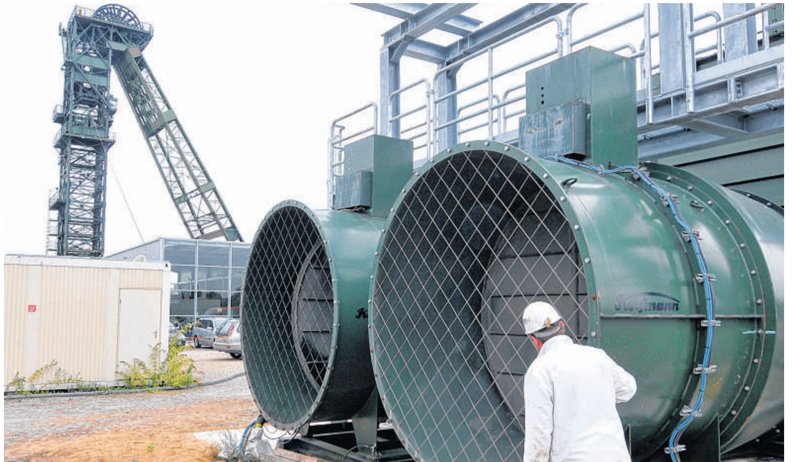
Mächtige Lüfter sorgen für die Bewetterung der Schächte auf Fürst Leopold.
