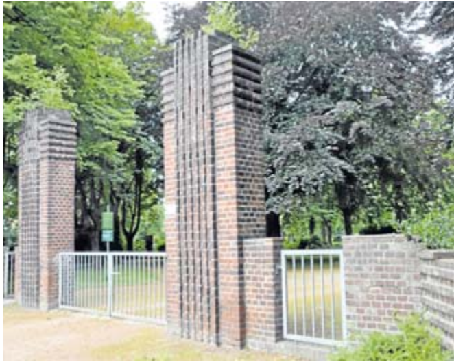
Birkenbäumchen wachsen aus den hohen Säulen, Risse durchziehen die Backsteinmauer – der Haupteingang des Marienfriedhofs macht keinen guten Eindruck.
