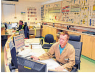
In der Steuerzentrale: Die Schalttafel ist nur noch Schaustück.
