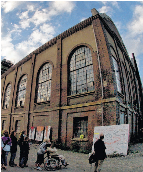
Für den Ausbau des Maschinenhauses (hier bei der Extraschicht im letzten Jahr) zum Dokumentationszentrum hat der Bergbauverein fast eine Million Euro Fördergelder beantragt. Foto: André Elschenbroich
