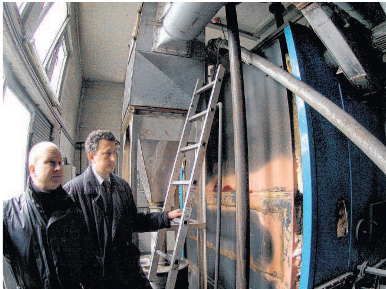
Detlef Probst und Michael Friedrich im Kohleheizwerk, das nach einem Bunkerbrand ausgefallen war.
