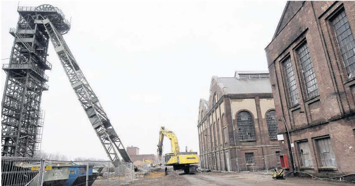
Zwischen dem freigelegten Fördererturm und dem Maschinenhaus reißt ein Bagger Beton aus dem Boden. Hier soll die Fürst-Leopold-Allee übers Gelände führen. Foto: Ralph Heeger
