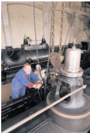
Im Maschinenhaus auf der ehemaligen Zeche Fürst Leopold steckt noch viel Arbeit für die AG „Dampfmaschine“. Foto: Franz Meinert
